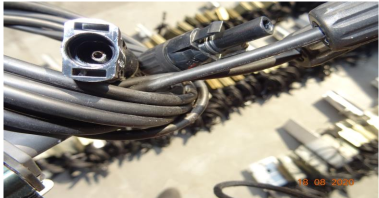
Corrosie in de connector Bron: Burghgraef Van Tiel & Partners
